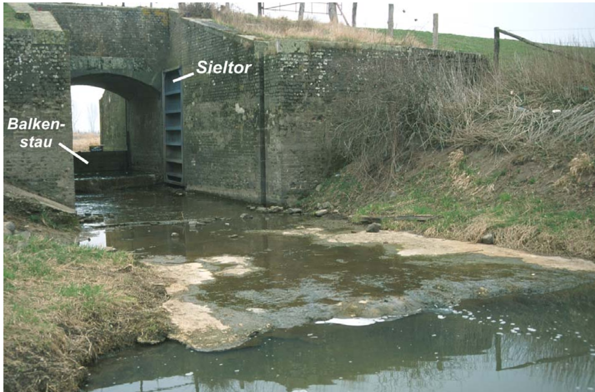
Abb. 4: Die Dornicker Schleuse vor dem Umbau. Man erkennt eines der Sieltore, den Balkenstau und die Betonplatte (Foto: M.Brühne).
