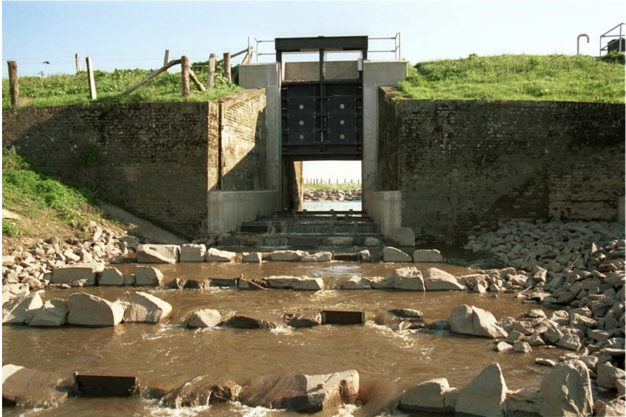
Abb. 8: Der Rauhgerinne-Beckenpass in der Dornicker Schleuse im Betrieb (Foto: M. Brühne).
